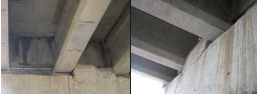
Figure 2.8: Damaged Shear Keys (23 Ekim 2011 Mw 7,2 Van Depremi Sismik ve Yapısal Hasara İlişkin Saha Gözlemleri, 2011)
