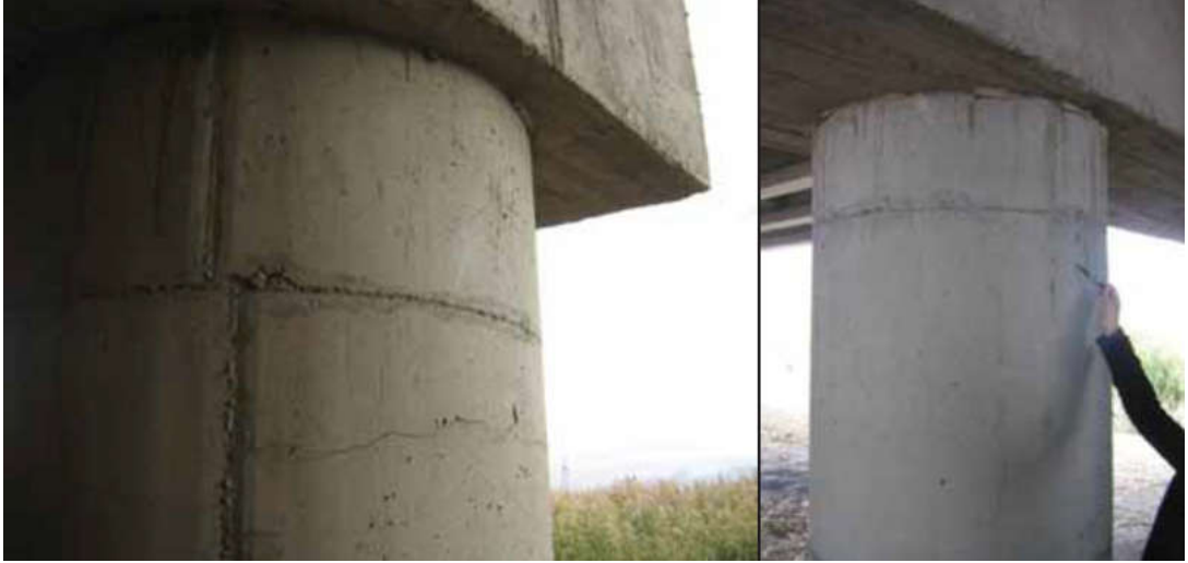
Figure 2.9: Flexural Cracks in Columns (23 Ekim 2011 Mw 7,2 Van Depremi Sismik ve Yapısal Hasara İlişkin Saha Gözlemleri, 2011)
