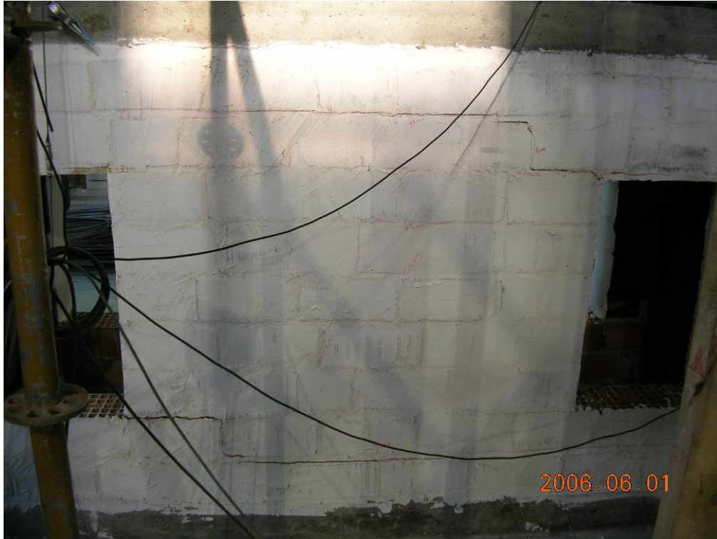
Şekil 133 – Güçlendirilmemiş (orijinal) bina deneyi, arka cephe çatlakları
