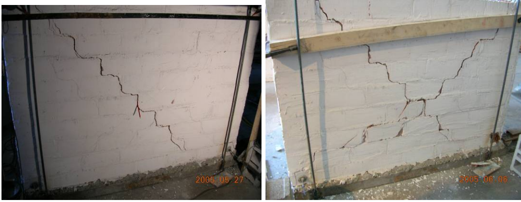
Şekil 80 – Güçlendirilmemiş duvar üzerinde oluşan çatlaklar
