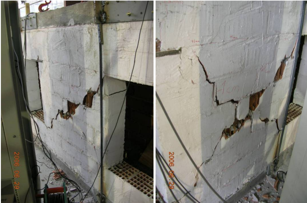
Şekil 142 – Düşey gergili test, diyagonal çatlakların oluşumu
