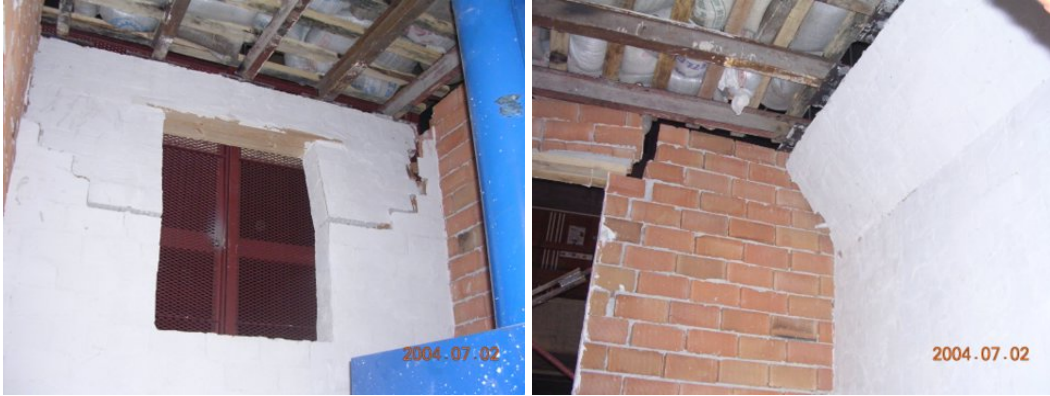
b) Zayıf duvarlar üzerinde oluşan çapraz çatlakların dağılımı
