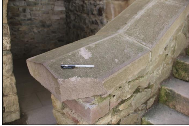
Şekil 6.3.2. Düşen blokların meydana getirdiği hasarlar (a,b,c)
