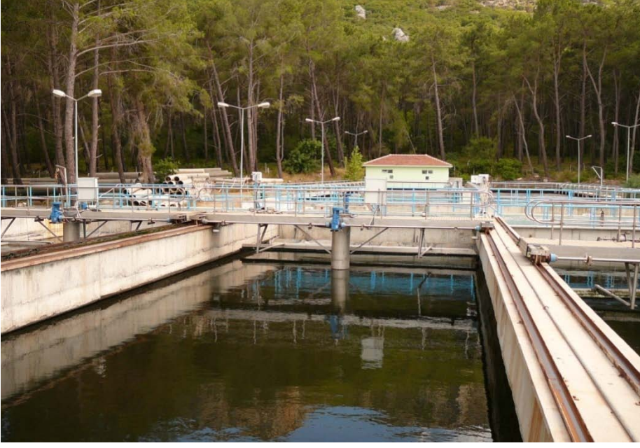
Şekil 2.22. Kemer 1 tesisi son çöktürme tankı
