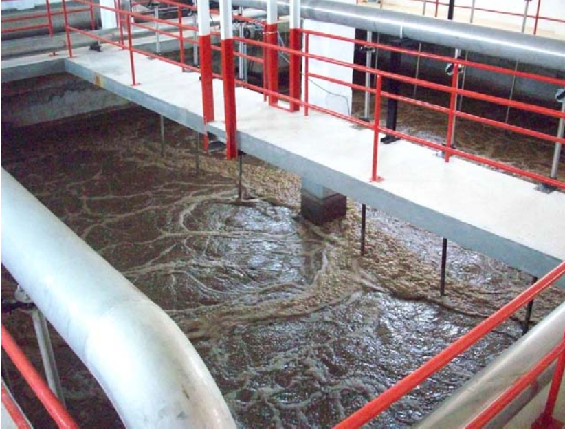
Şekil 2.27. Konacık MBR Atıksu arıtma tesisi havalandırma tankı.
