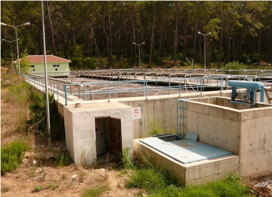
řekil 2.21. Difüzör havalandırmalı Kemer 1 tesisi
