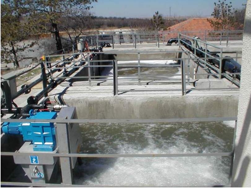
Şekil 2.31. VRM Atıksu Arıtma tesisi görünüş
