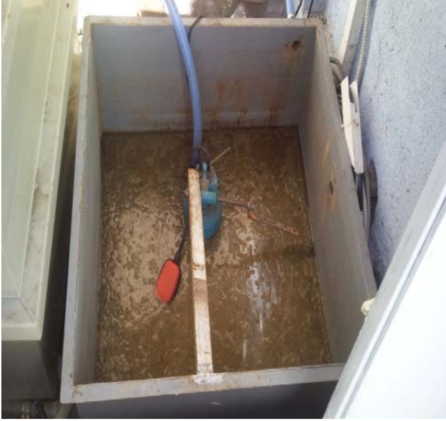
Şekil 2.34. Depolama ve dengeleme tankı
