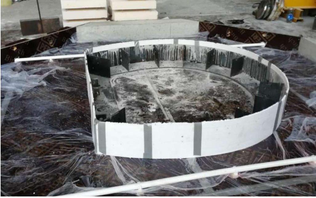
Şekil 3.52 Kaya katmanı ile betonarme tünel kaplaması arasında daha sonra çıkarılmak üzere yerleştirilen yaklaşık 1 cm kalınlığındaki köpük katman.
