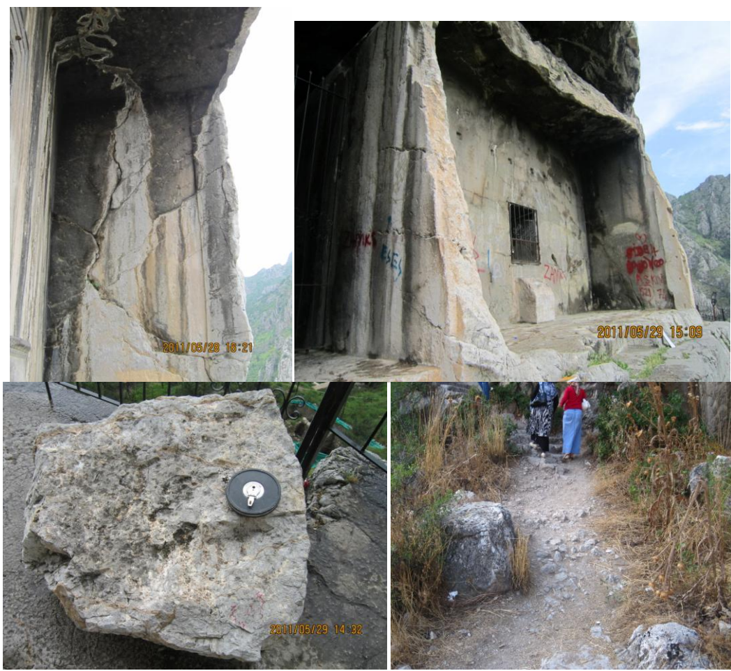
Şekil 20. Kral mezarı yapısı civarında düşen ve asılı duran bloklar
