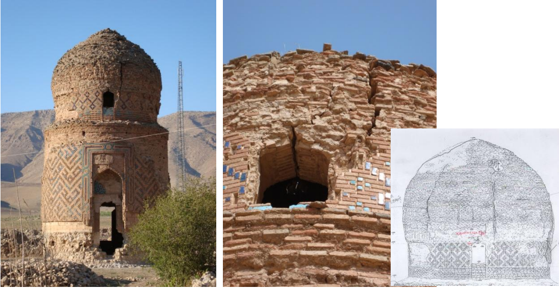
Şekil 53 – Zeynelbey Türbesi, kubbede oluşan aşırı çatlaklar.
