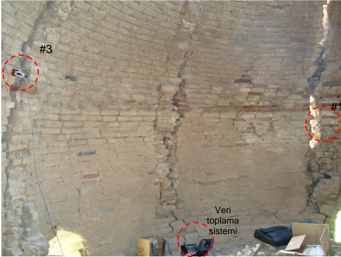
Şekil 55 – Zeynelbey Türbesi, çatlak ölçerlerin yerleri ve kanal numaraları.
