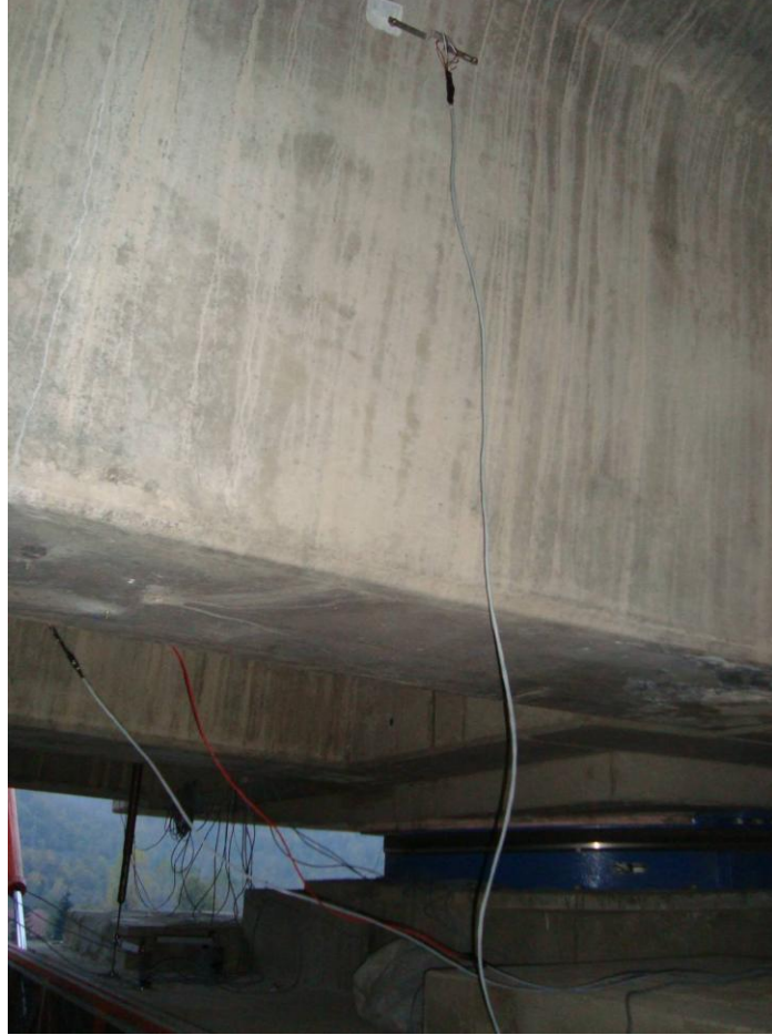
Şekil 93 – Bolu Viyadüğü YSİ sistemi birim deformasyon ölçerler.
