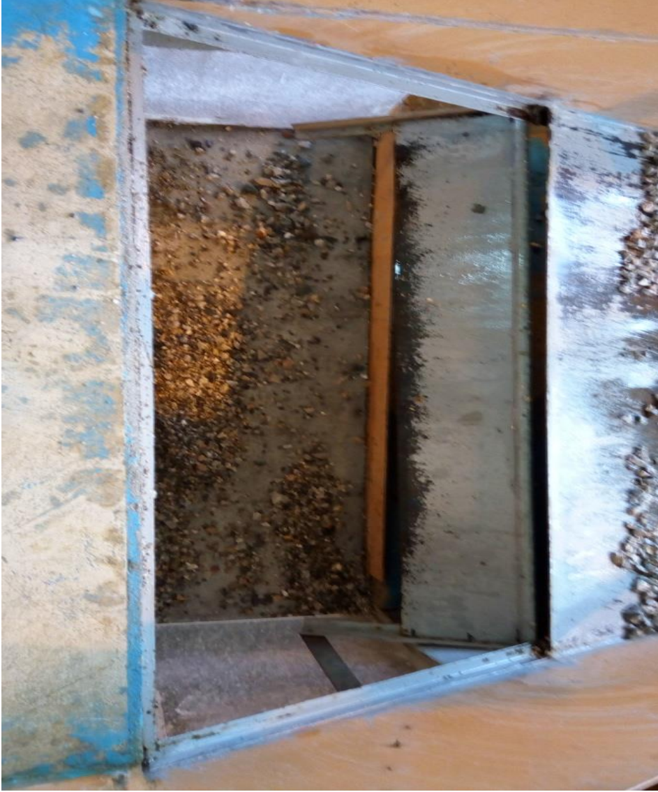
Şekil 3.19 Katı madde ile yapılan deneylerde (D-Grubu) “toplama kanalı-1” in içerisinde biriken katı maddenin üstten görünüşü ( e_4=15 mm, Z_1=10 cm, Z_2=20 cm, \alpha=30^\circ )
