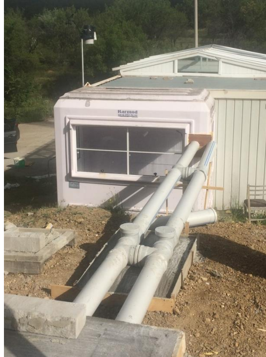
Şekil 3-4. Güneş toplama sistemleri kontrol odası
