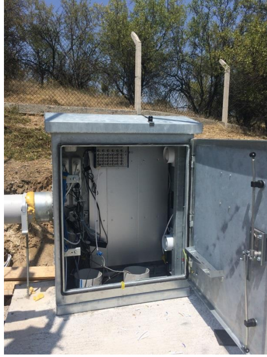
Şekil 3-3. Trafo kutusu içerik detayları
