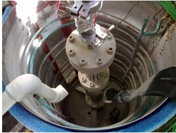
Şekil 4.9 Yoğuşturucu ünitesi ve yerleştirildiği su tankı.
