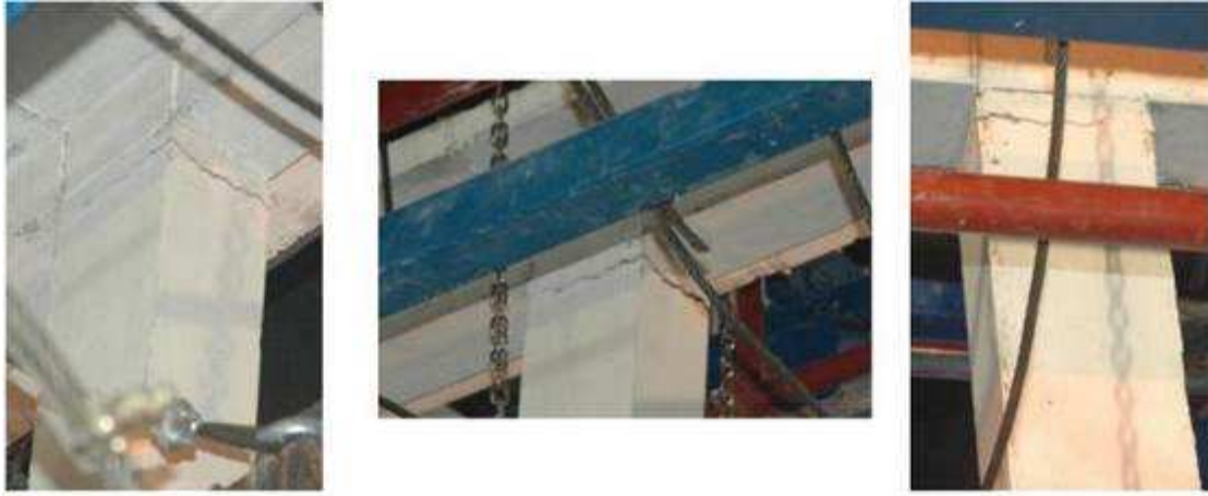
Şekil 3.19. Referans çerçevesinde 3. Katta meydana gelen yapısal hasarlar (Mutlu 2012)
