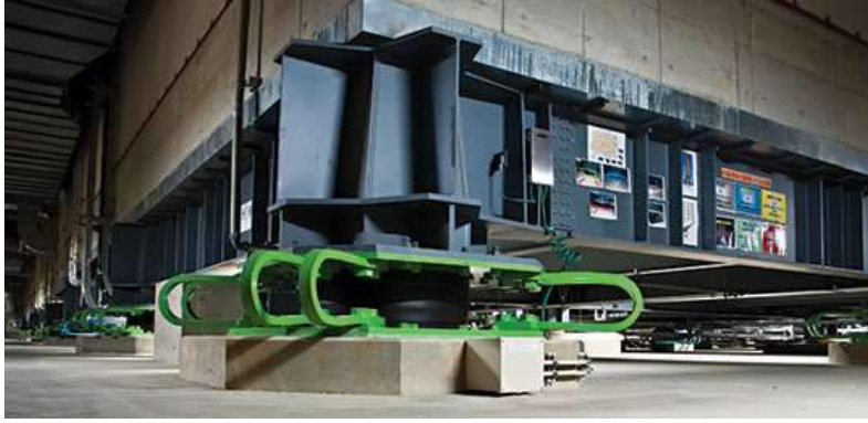
Şekil 1-11. Ishinomaki Red Cross Hastanesi'nin 100 doğal kauçuk mesnetten ve U-şekilli çelik damperden oluşan izolasyon bodrumu (Fotoğraf Seismic Isolation Engineering, SIE, Inc.'den alınmıştır.). Bina M9.0 Büyük Tohoku Depreminden (11 Mart 2011) sonra da kullanılabilir durumda kalmıştır (Taylor ve Aiken 2012).
