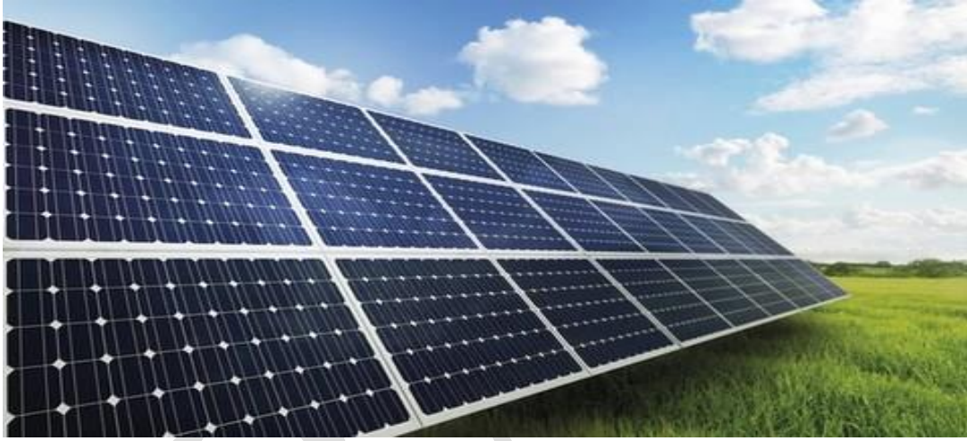
Şekil-2. Güneş paneli [6].
