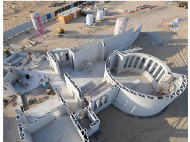
Görsel 1: Dubai'de üç boyutlu basım tekniği ile inşa edilen bina ( https://www.businessinsider.com/dubai-largest-3d-printed-building-apis-cor-photos-2019-12 ) ET: 18.01.2020
